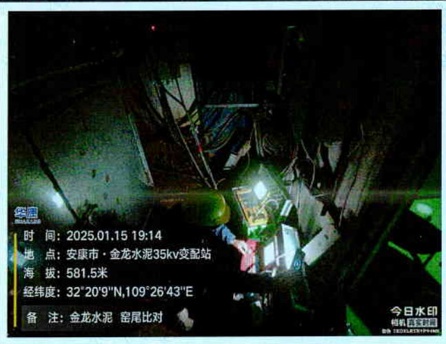
窑尾废气排放口 (DA011)
