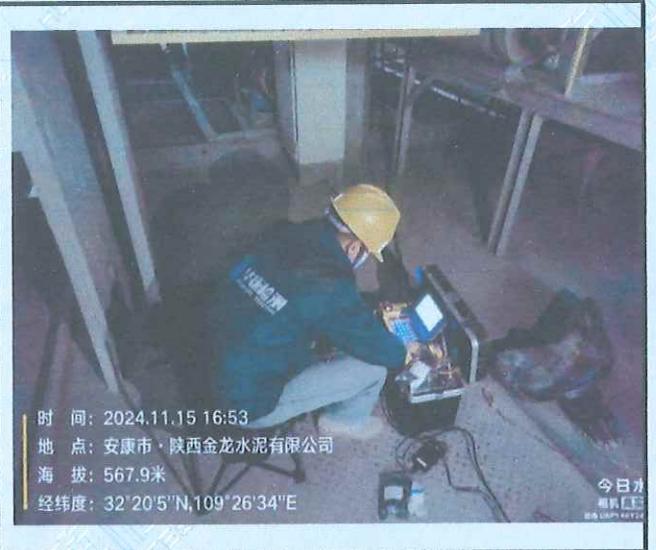
1#袋装水泥装车废气排气筒 (DA041)
