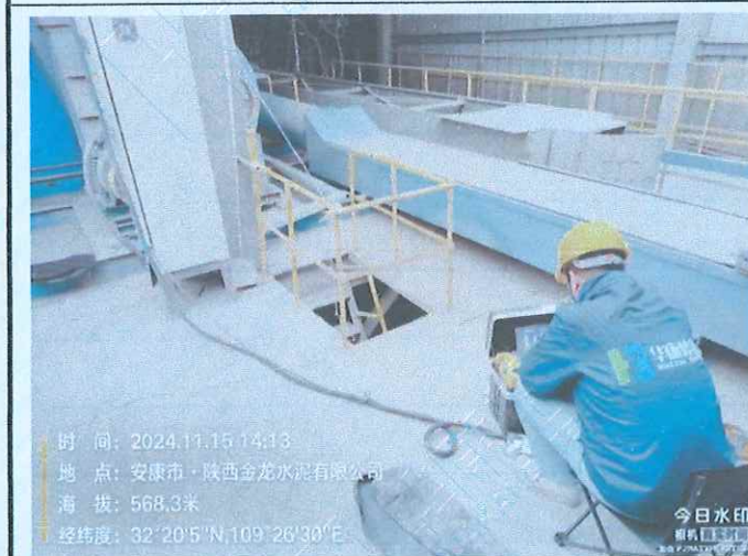
2#袋装水泥装车废气排气筒 (DA042)
