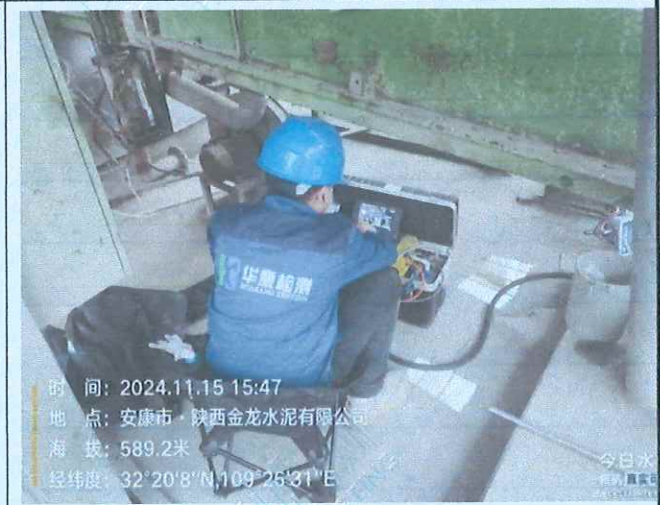
水泥装八废气排气筒 (DA060)
