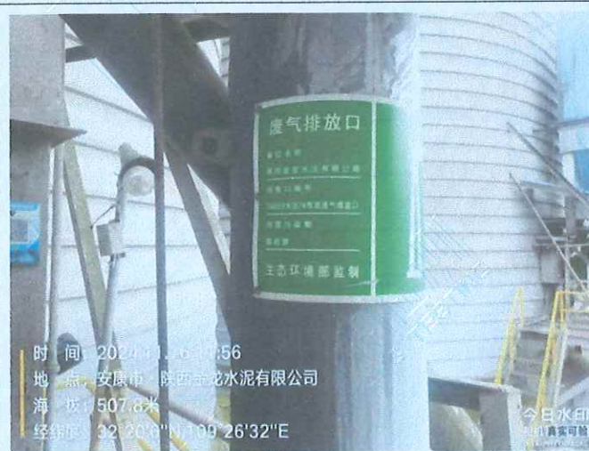
水泥装七废气排气筒 (DA059)
