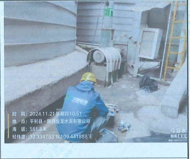
入包装机斗提废气排气筒 (DA046)
